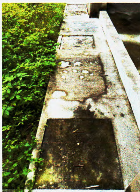
Figura 112 – Caixas de Drenagem de água Pluviais – Fonte:Própria;
