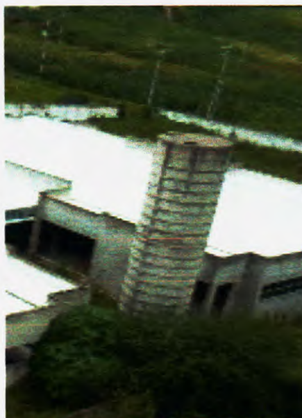
Figura 148 –Falta execução Para-raio – Fonte:Própria;
