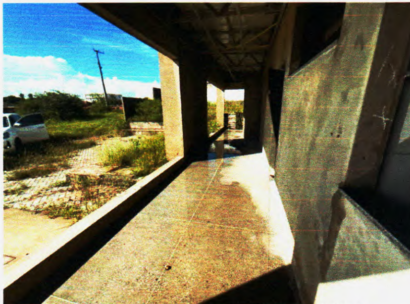
Figura 157 – Falta Prateleiras na Varanda de Serviço – Fonte:Própria;
