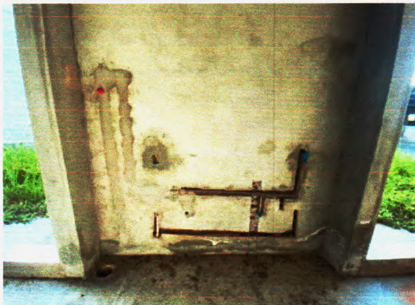
Figura 116 – Pontos Sanitários – Fonte:Própria;
