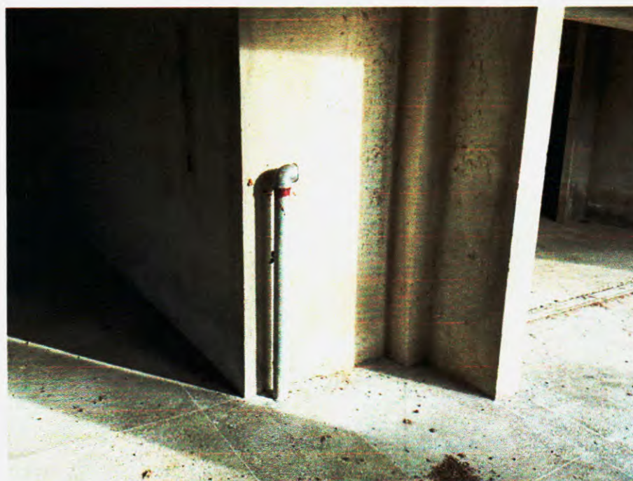
Figura 130 – Ponto Hidrante Interno – Fonte:Própria;
