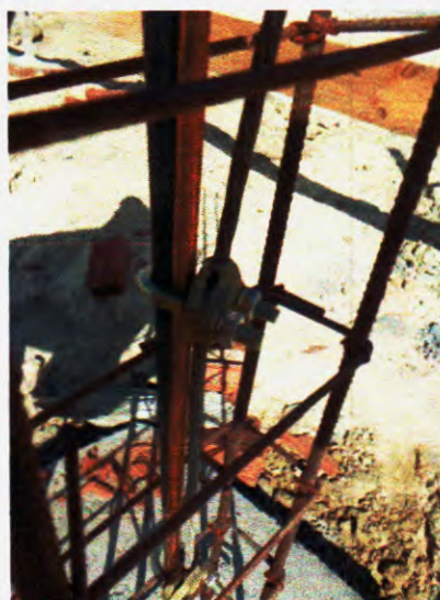
Figura 147 – Haste de aterramento Concreta com a Super estrutura – Fonte: Registro fotográfico da época da execução;
