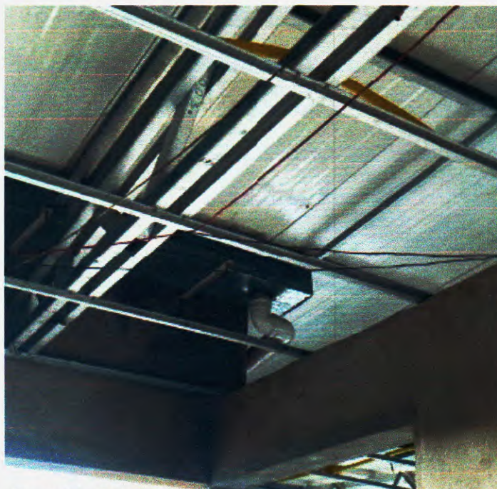
Figura 110 – Tubulação de Drenagem de águas Pluviais – Fonte: Própria;
