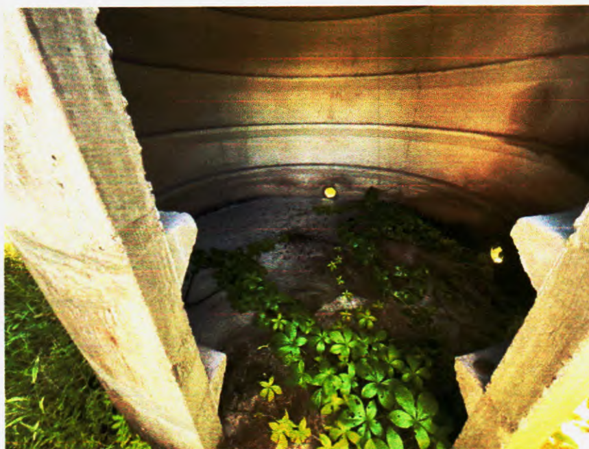
Figura 100 –Castelo D'água sem tubulação instalada – Fonte:Própria;
