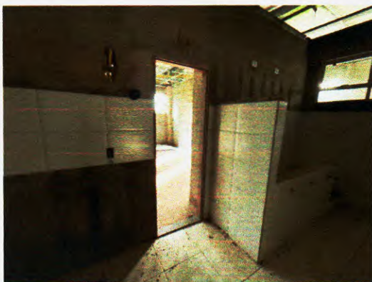
Figura 121 – Falta de Louças e Metais – Fonte:Própria;
