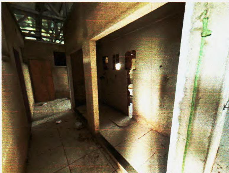
Figura 132 – Shaft Elétrica falta quadros – Fonte:Própria;
