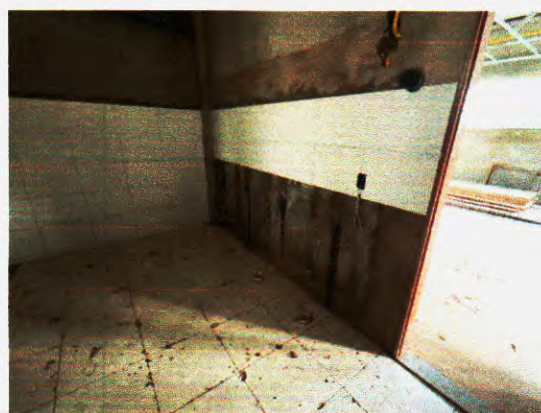
Figura 120 – Falta de Louças e Metais – Fonte:Própria;
