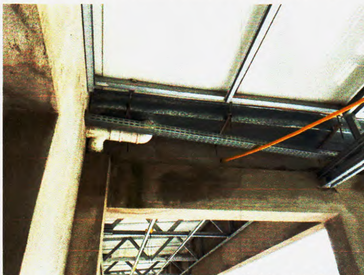
Figura 108 – Tubulação de Drenagem de águas Pluviais – Fonte: Própria;
