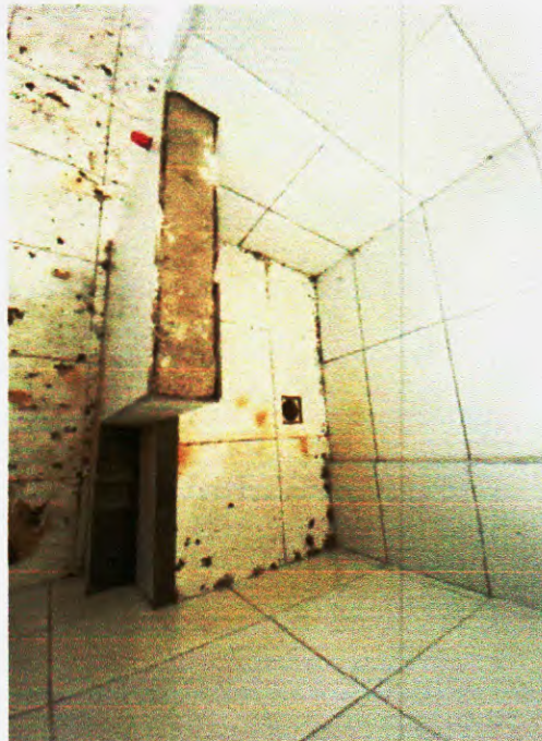
Figura 161 – Falta de peitoril em granito – Fonte:Própria;
