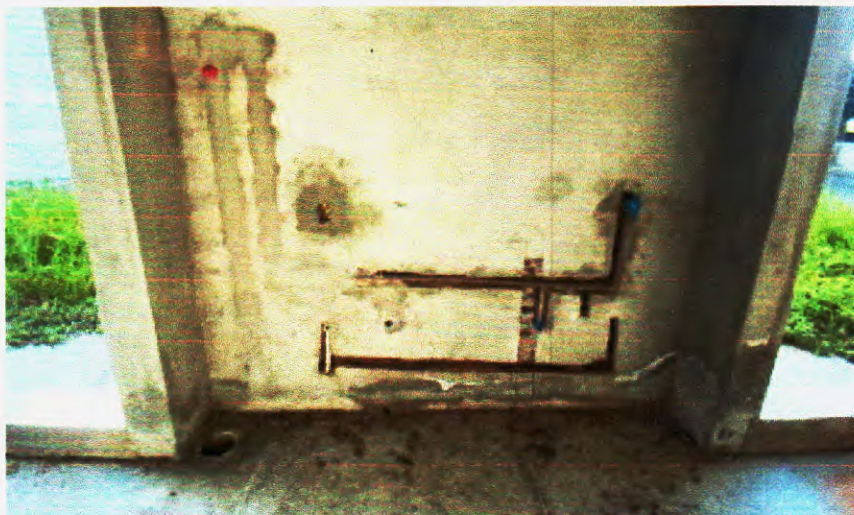
Figura 153 – Falta de Bancada de granito – Fonte:Própria
