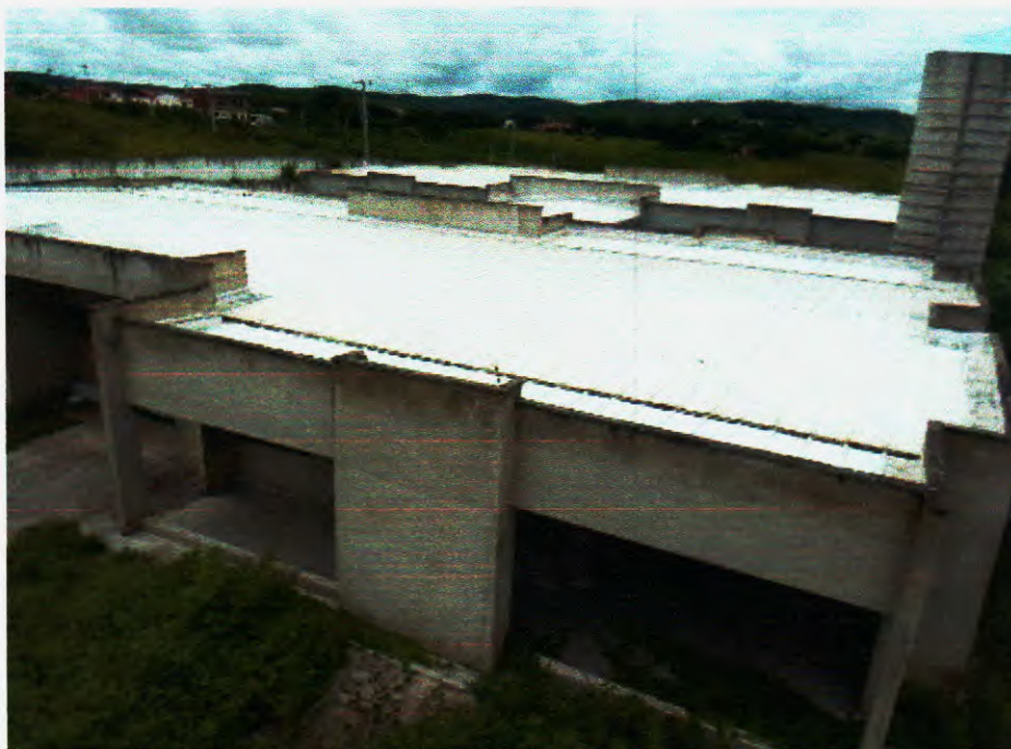
Figura 149 – Falta executar cordoalha SPD na coberta – Fonte:Própria;
