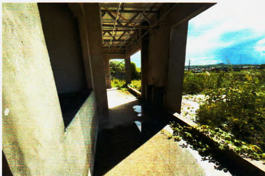
Figura 152 – Falta de Bancada de granito – Fonte:Própria
