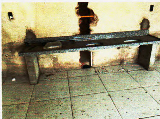
Figura 122 – Louças Instaladas – Fonte:Própria;
