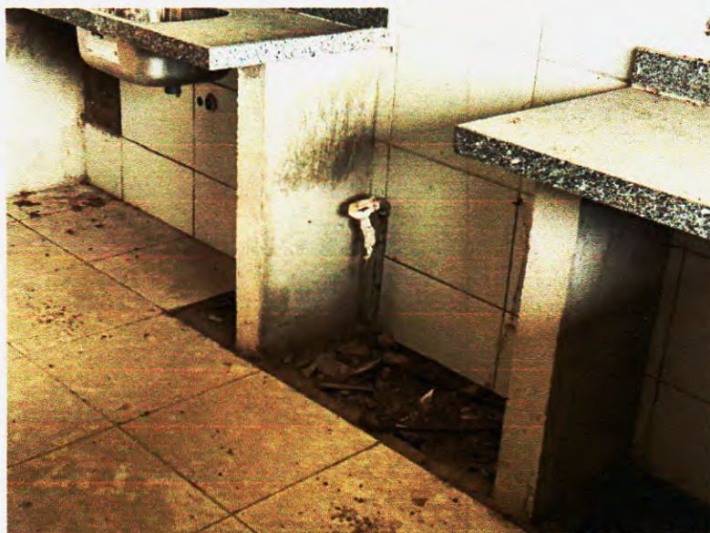
Figura 127 – Ponto de Gás executado no Lactário – Fonte:Própria;
