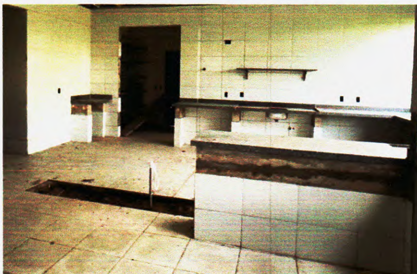
Figura 128 – Ponto de Gás executado na cozinha – Fonte:Própria;
