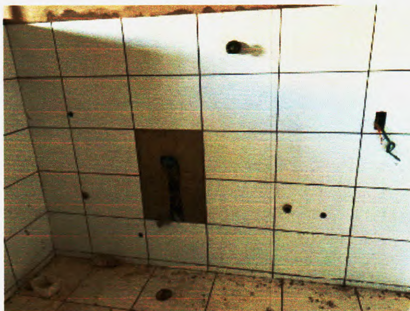
Figura 118 – Pontos Sanitários – Fonte:Própria;
