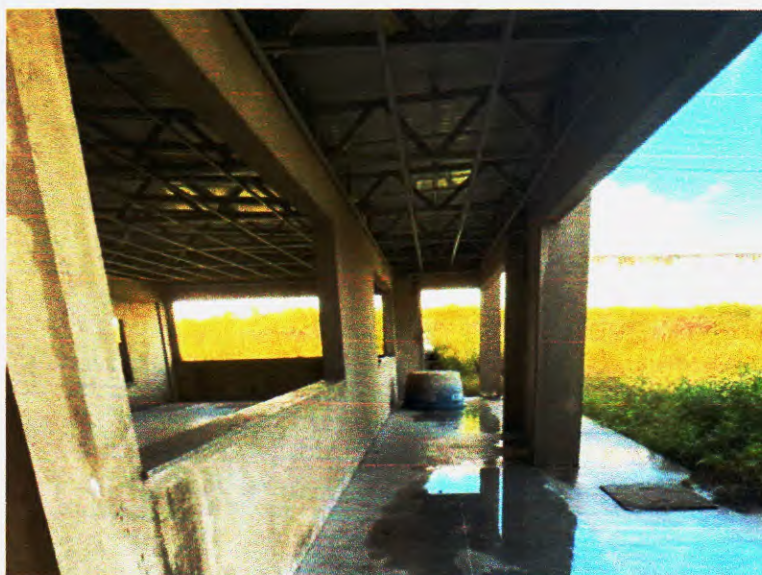
Figura 158 – Falta prateleiras Varanda (Depósito Playground) – Fonte:Própria;
