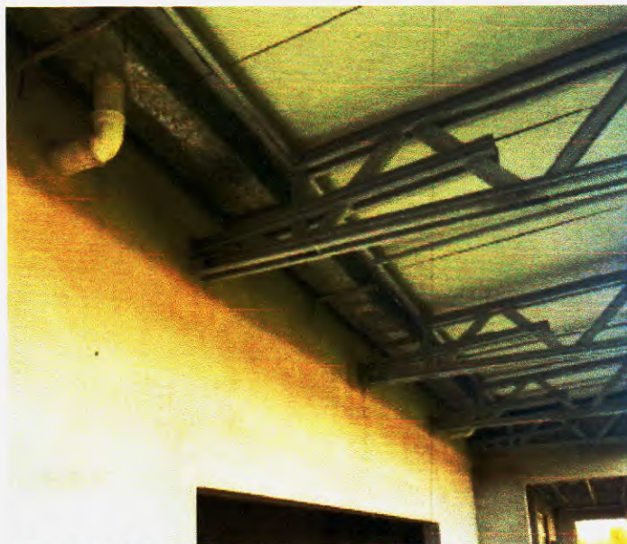
Figura 111 – Tubulação de Drenagem de águas Pluviais – Fonte:Própria;
