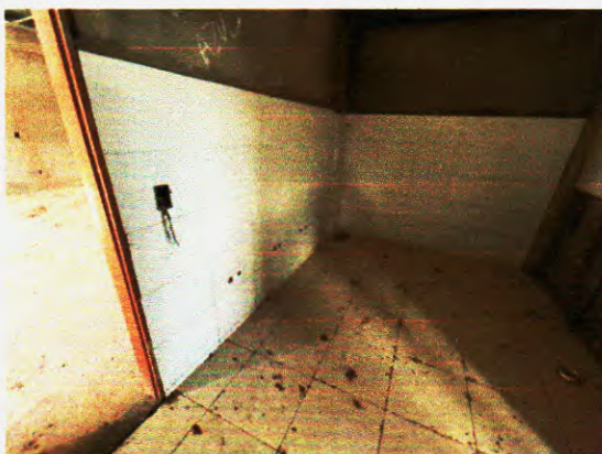
Figura 119 – Falta de Louças e Metais – Fonte:Própria;
