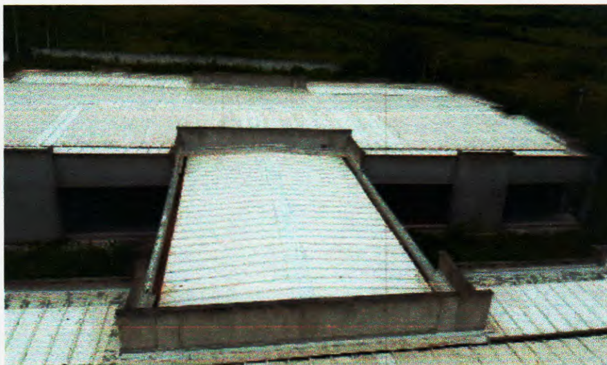
Figura 150 – Falta executar cordoalha SPD na coberta – Fonte:Própria;
