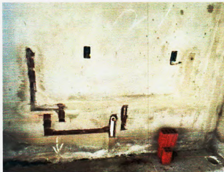
Figura 114 – Pontos Sanitários – Fonte:Própria;
