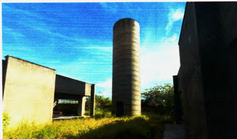
Figura 99 –Castelo D'água sem tubulação instalada – Fonte:Própria;
