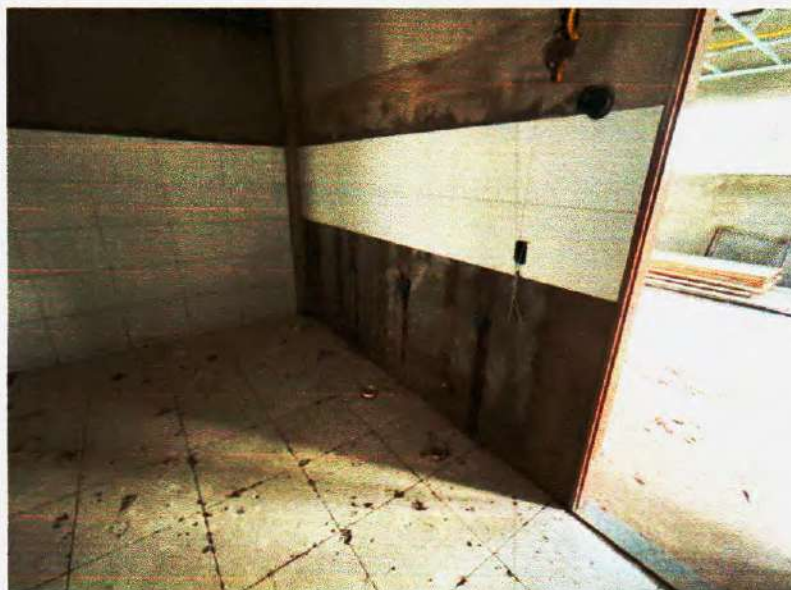
Figura 27 – Falta de Divisórias de granito nos banheiros – Fonte: Própria
