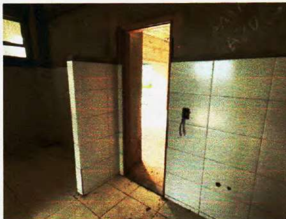
Figura37 – Ausência de Portas– Fonte:Própria;
