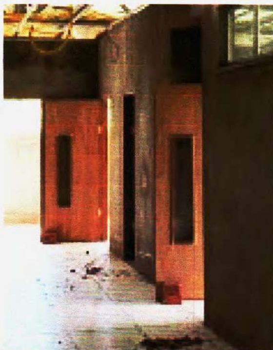
Figura39 – Portas de madeira sem vidro, sem batedor e sem fechadura– Fonte:Própria
