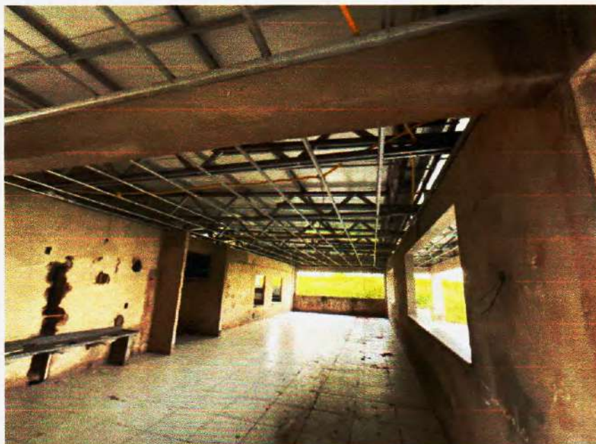
Figura 73 – Forro de Fibra Mineral não Executado – Fonte: Própria;
