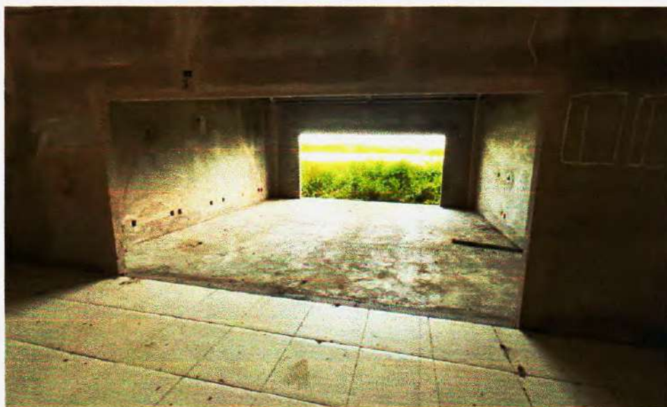
Figura 45 – Ausência de Portas de alumínio de vidro– Fonte:Própria;
