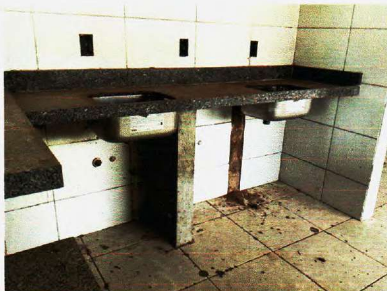
Figura 67 – Acabamentos revestimento Cerâmico não executado – Fonte:Própria;
