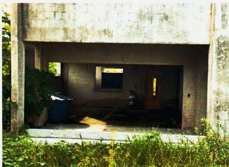
Figura 43 – Ausência de Portas de alumínio de vidro– Fonte:Própria;
