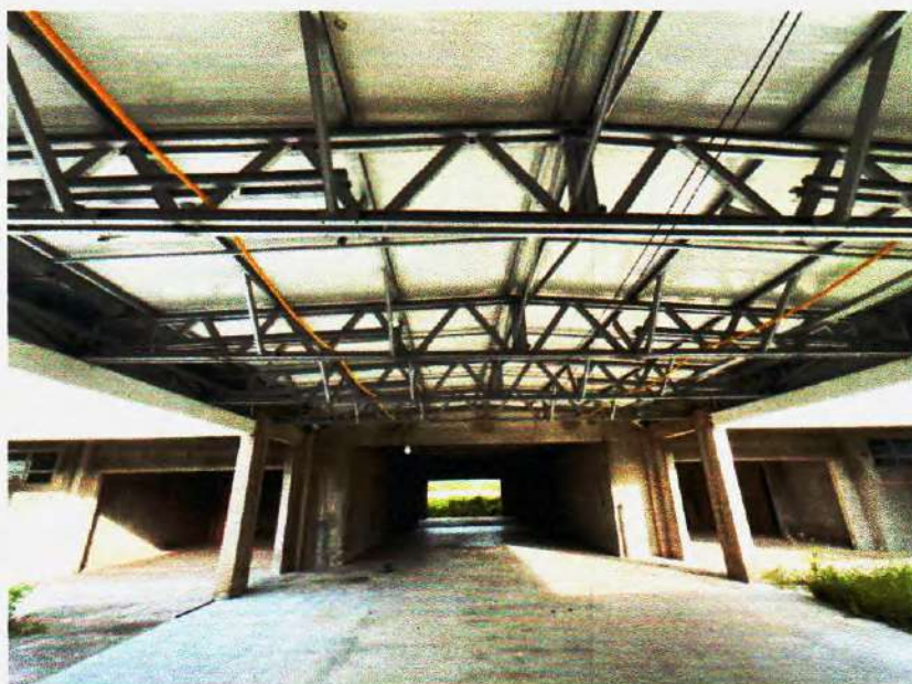
Figura 72 – Forro de Fibra Mineral não executado – Fonte:Própria
