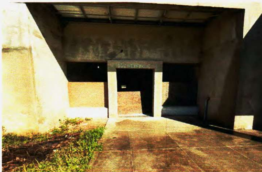
Figura 46 – Ausência de Portas de alumínio de vidro– Fonte:Própria;
