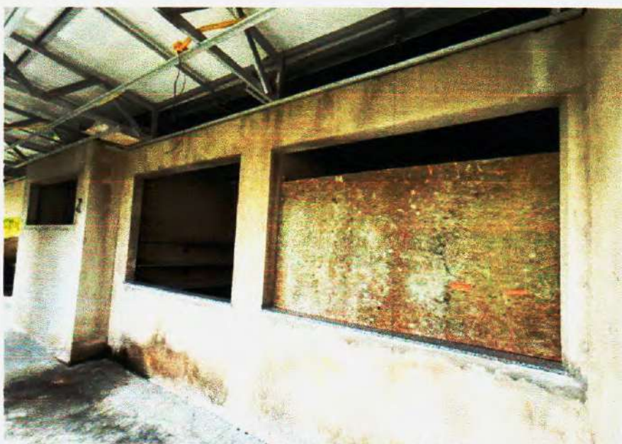
Figura 47 – Ausência de janelas– Fonte:Própria;
