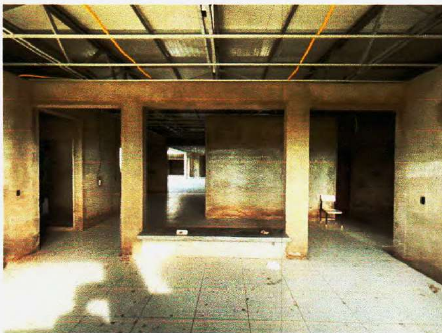
Figura 25 – Não execução dos elementos vazados – Fonte: Própria;
