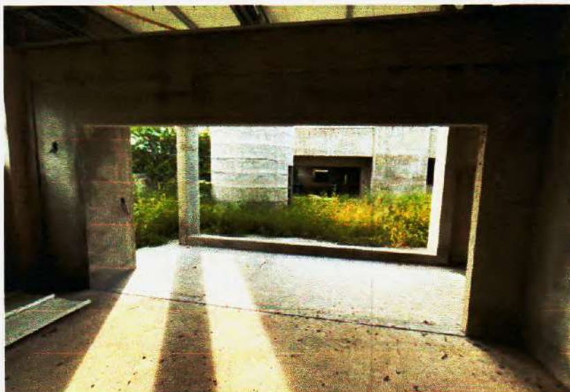
Figura 42 – Ausência de Portas de alumínio de vidro– Fonte:Própria;
