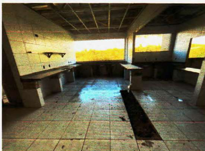
Figura 50 – Ausência de janelas– Fonte:Própria;
