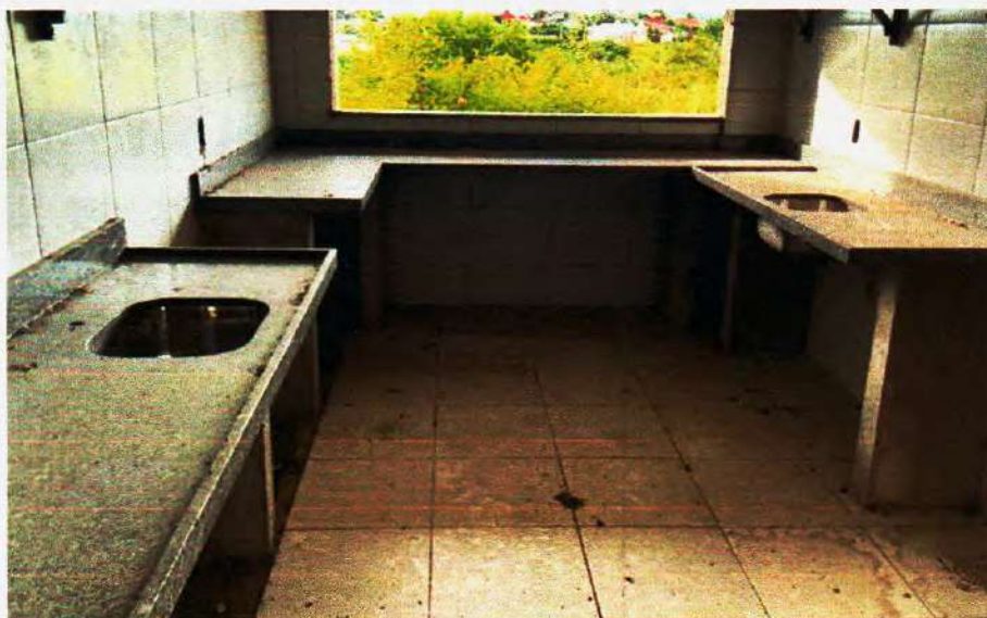
Figura 69 – Acabamentos revestimento Cerâmico não executado – Fonte: Própria;
