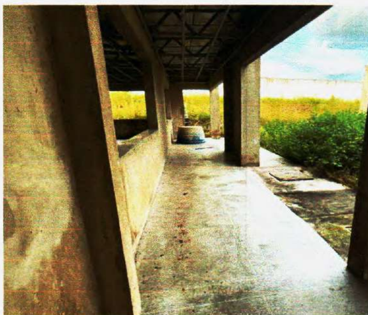
Figura 66 – Alvenaria em sinal de infiltração – Fonte:Própria
