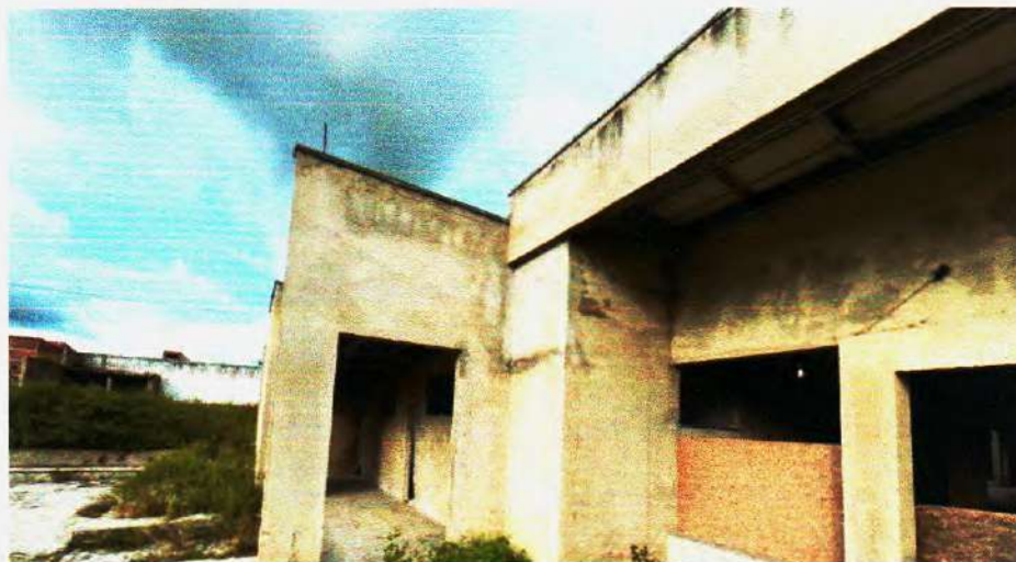
Figura 75 – Forro de Gesso não executado – Fonte: Própria;
