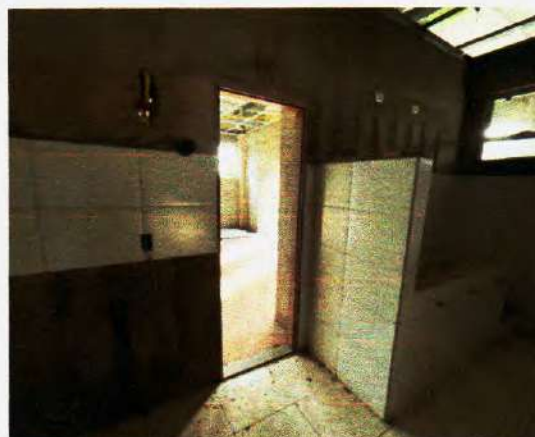
Figura 38 – Ausência de Portas– Fonte:Própria;
