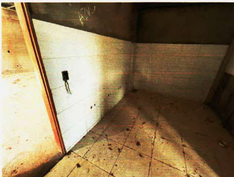
Figura 26 – Falta de Divisórias de granito nos banheiros – Fonte: Própria
