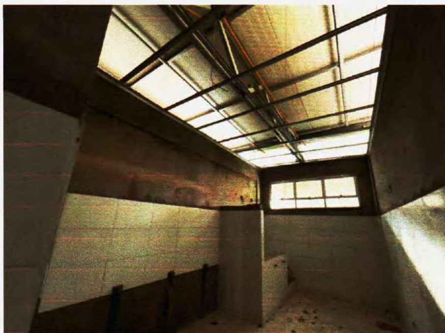
Figura 70 – Revestimento Cerâmico Colorido não executado – Fonte: Própria;
