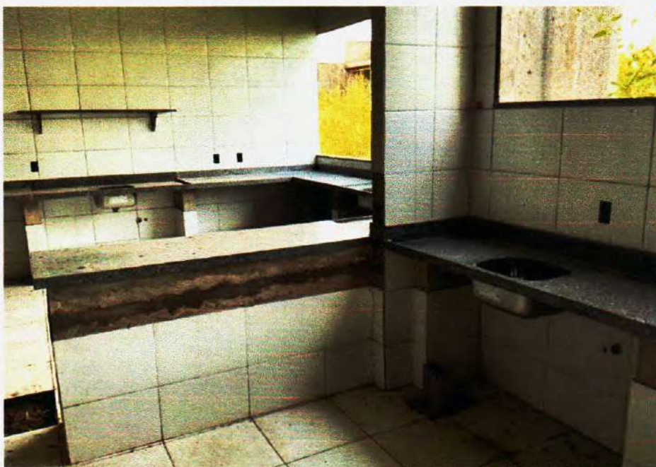
Figura 68 – Acabamentos revestimento Cerâmico não executado – Fonte:Própria
