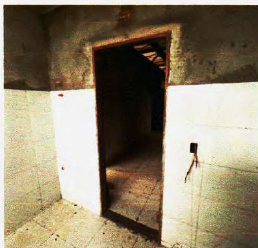
Figura39 – Ausência de Portas– Fonte:Própria
