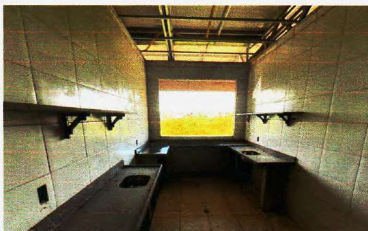
Figura 49 – Ausência de janelas– Fonte:Própria;
