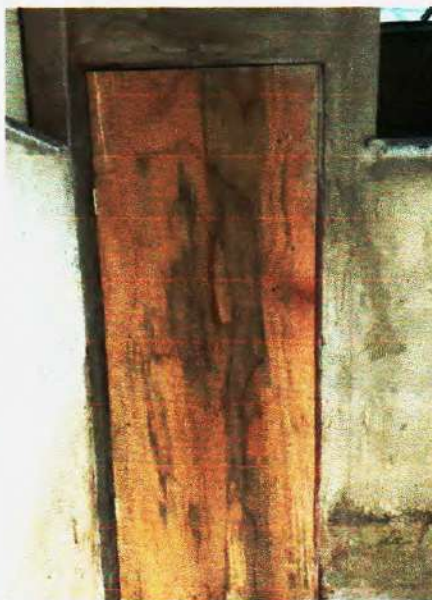
Figura40 – Portas de madeira de má qualidade– Fonte:Própria
