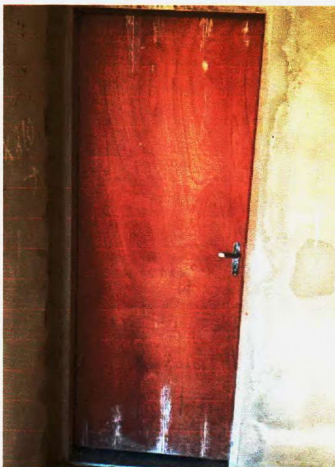
Figura41 – Portas de madeira de má qualidade– Fonte:Própria
